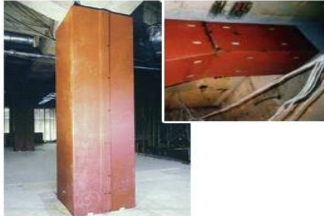
〈사진 3〉 강판에 의한 기둥 및 보 보강 사례 10)
